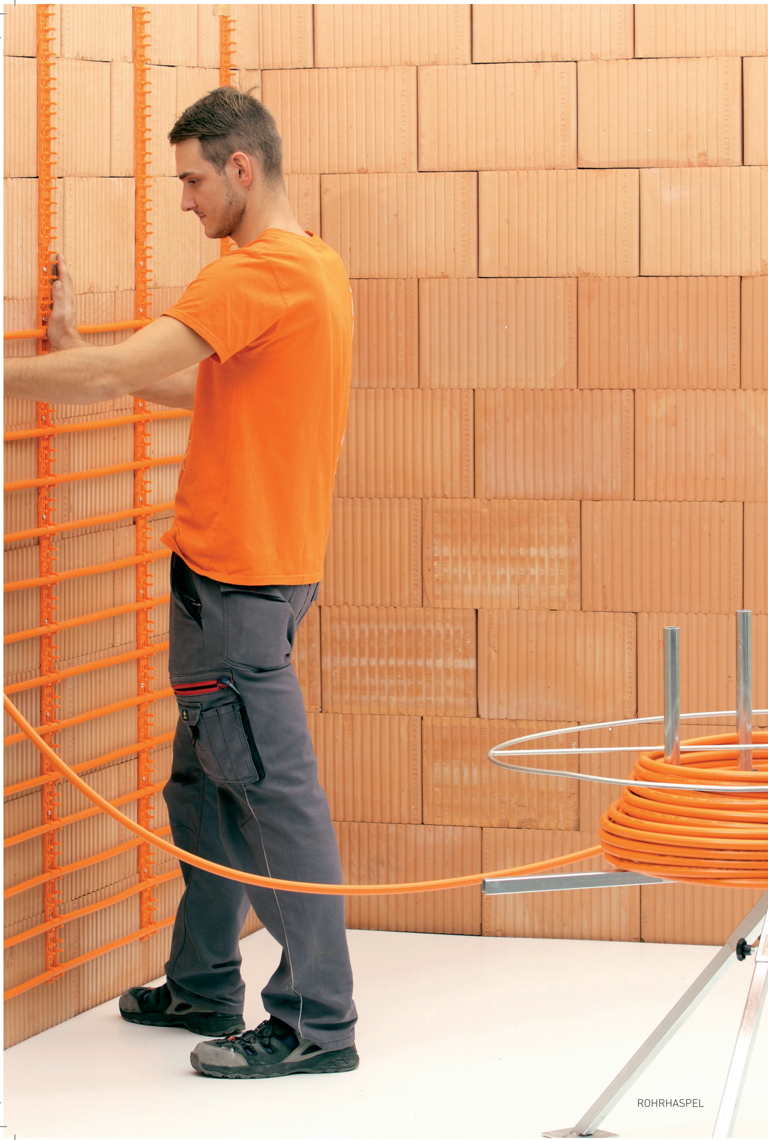
VERPUTZTE WANDHEIZUNG I KÜHLUNG
